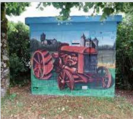
Poste à Fieux
